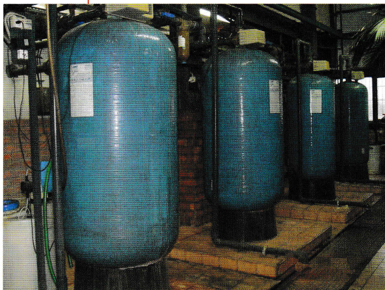
FOT. 3 Zbiorniki odżelaziania i odmanganiania wody (źródło: MPEC Włocławek)
