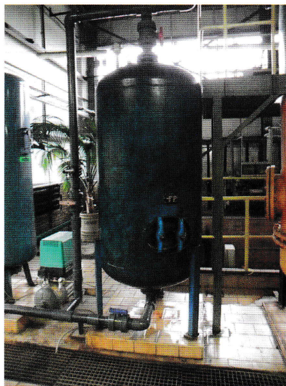
FOT. 2 Zbiornik napowietrzający wodę (źródło: MPEC Włocławek)
