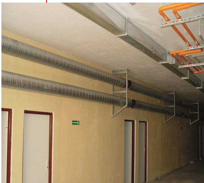
FOT. 1 Sieć ciepłownicza wewnątrz budynku
