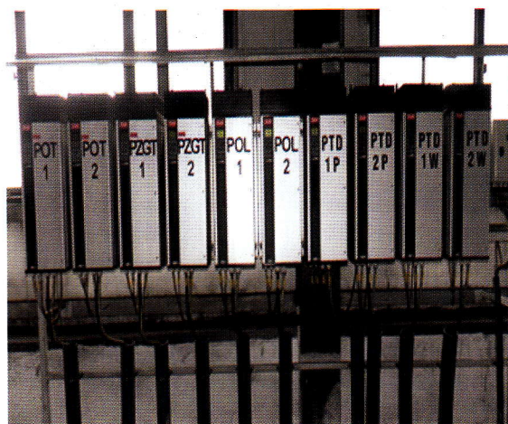
FOT. 1 Przetwornice częstotliwości w układzie technologicznym pompowni w ciepłowni Źródło: MPEC-Włocławek
