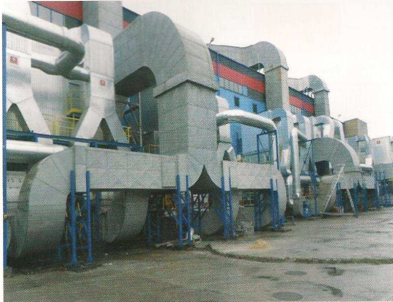
Fot. 1. Instalacja odpylania ciepłowni
