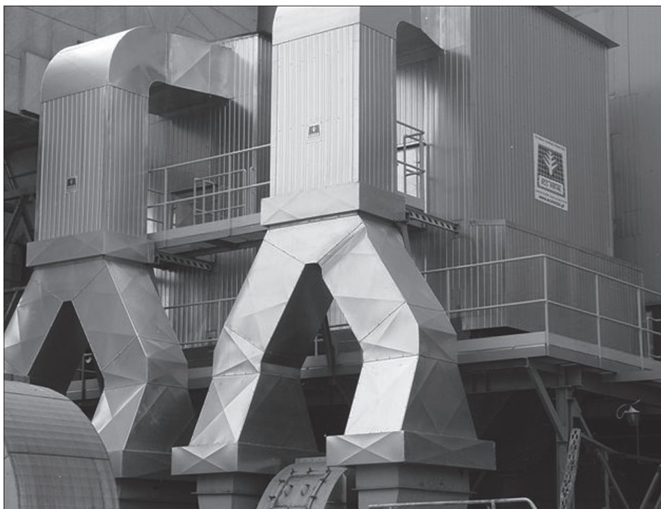
Fot. 4. Instalacja odpylania kotła WR-25 nr 5
